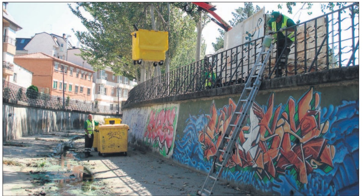
Imagen de los trabajos que se han venido desarrollando para la limpieza del río Guadarrama
